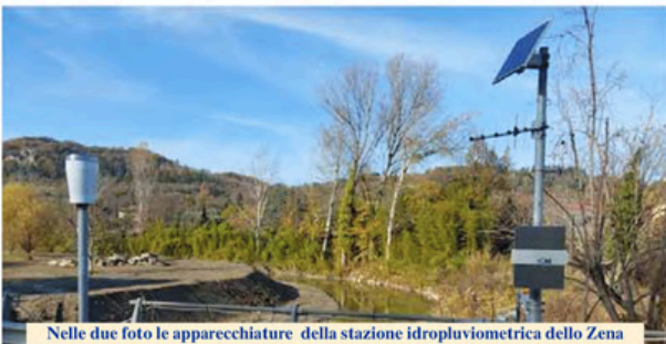
Nelle due foto le apparecchiature della stazione idropluviometrica dello Zena
